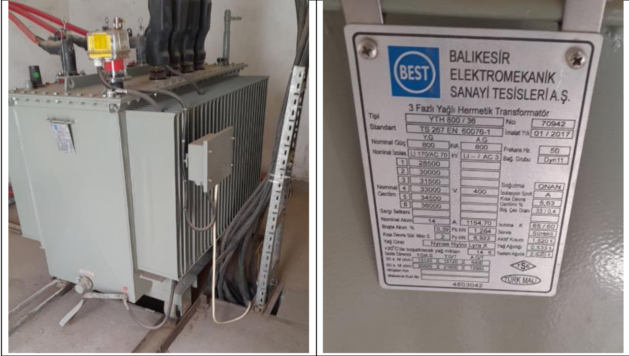
Resim 6-42 Isı Merkezi TR2 Trafo
